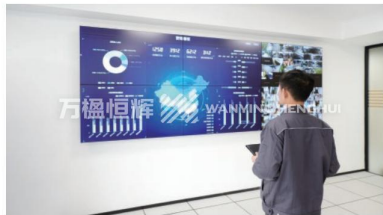
数据中心 | Data Center
